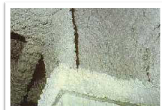
Particolare di mattoni contenenti amianto.
