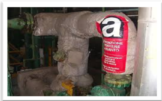
Condotte coibentate con amianto.
