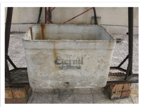
Serbatoio per l'acqua in eternit.
