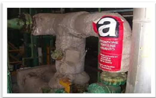
Condotte coibentate con amianto.
