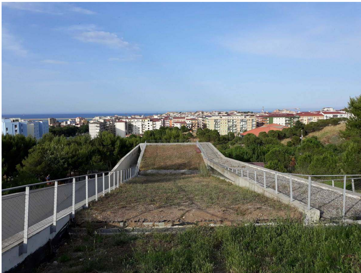
Copertura del Museo Pitagora per futuro allestimento a tetto giardino e/o fotovoltaico
